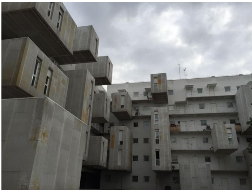
Imagen 3. Deterioro de viviendas (fuente: El autor, 2016).
