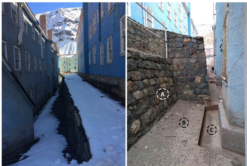
(A) Muro de contención en pendiente (B) Nivel de llegada inclinado (C) Canalización de aguas.
