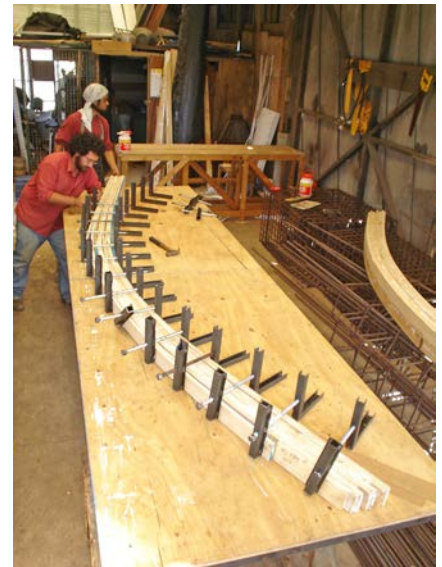
Imagen 3. Construcción de las cuadernas estructurales de la hospedería colgante, sobre una matriz diseñada por los alumnos (fuente: Archivo Histórico José Vial Armstrong, EAD-PUCV, 2014).
