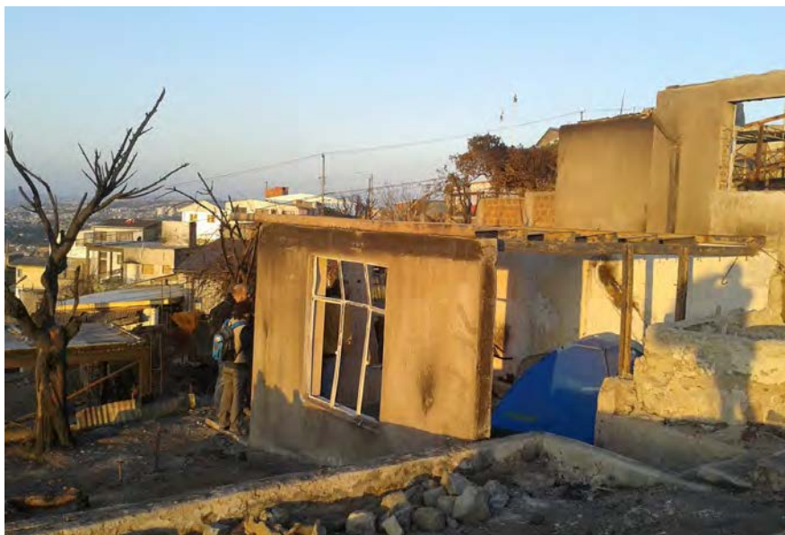
Imagen 2. Viviendas post incendio (fuente: Verónica Maturana).
