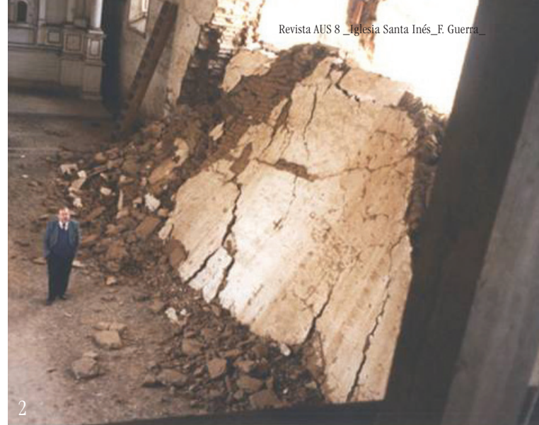
Imagen 1_Estado inicial de la iglesia previa a su restauración.
