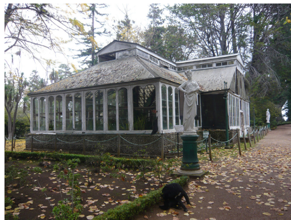
Imagen 4. Invernadero de plantas tropicales, destruido por el terremoto de febrero de 2010 (fuente: María Dolores Muñoz).
