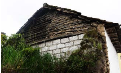
Imagen 23. Hastial de la vivienda número 24, donde se puede ver la estructura y componentes del bahareque en combinación con el bloque de hormigón (fuente: Daniel Díez).
