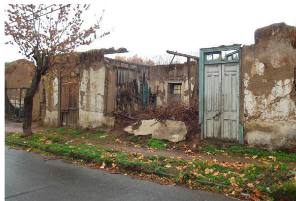
Imagen 2. Viviendas con carácter patrimonial destruidas por el terremoto (fuente: Los autores 2015).
