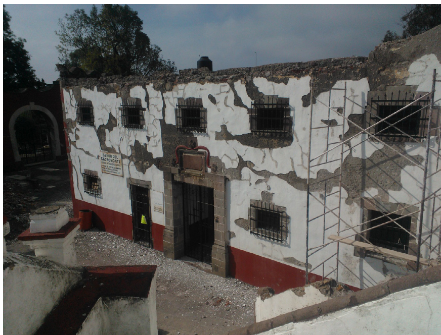
Imagen 7. Vista de los daños en el claustro (fuente: Cortesía de Eder Torres Villamar del Consejo Parroquial, 2017).
