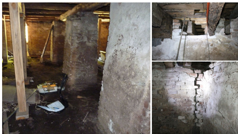
Imagen 5. Estado sistema estructural en zócalo (fuente: de los autores, 2022).
